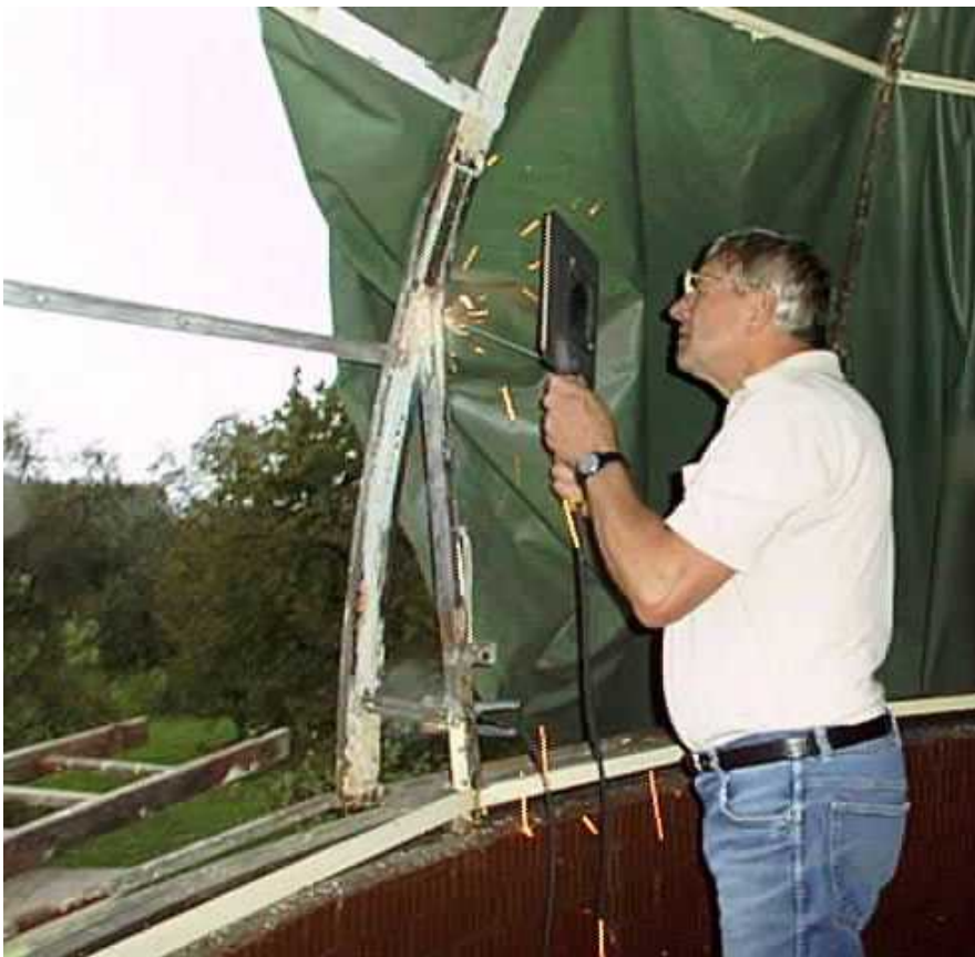
Hanspeter Moos kratzt die alte Lackierung und Rost vom Stahlgerüst. Valnero Grassi beim Ausbessern defekter Stellen im Stahlgerüst (WB)
